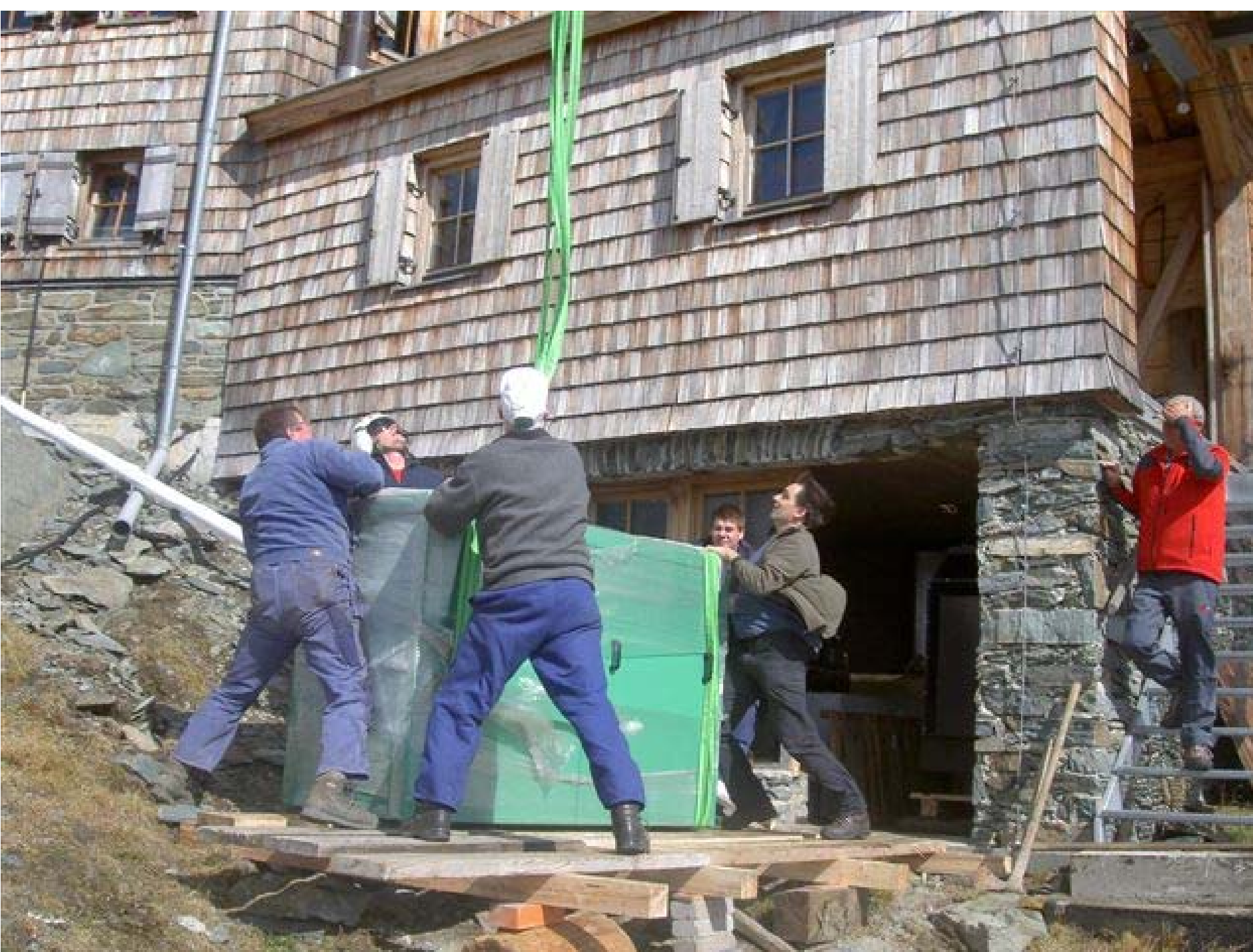
Lieferung des BHKW mit Hubschrauber
